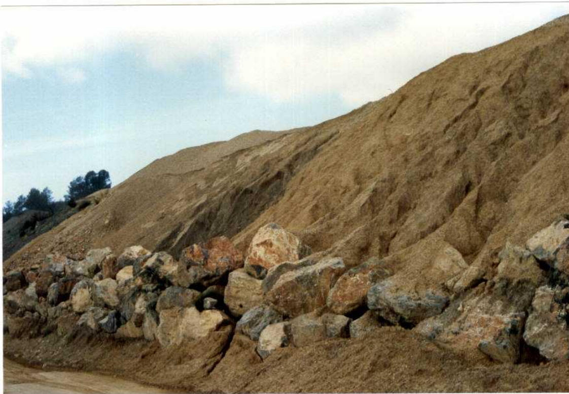
Foto nº 6. Deslizamiento local y erosión en la estructura 34-17-1-3.
